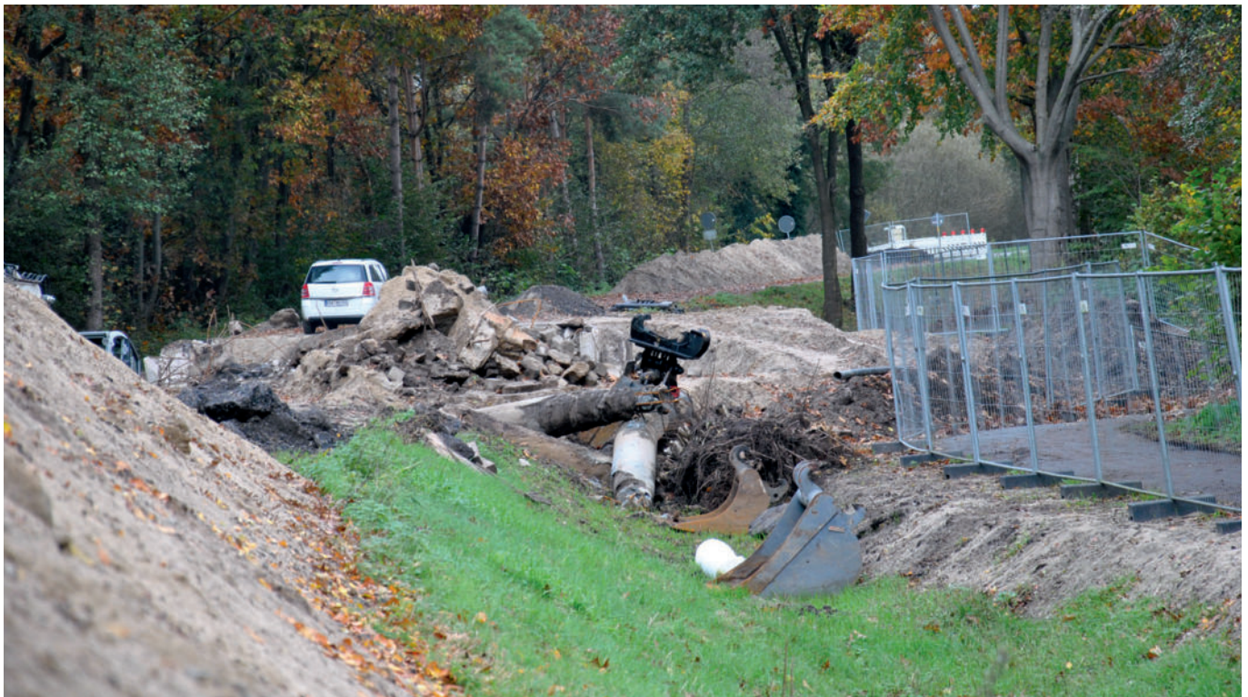
Von der Wörpebrücke zwischen Wilstedt und Tarmstedt sind nur noch Reste vorhanden.
