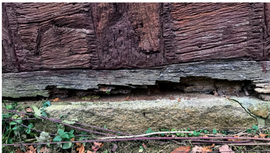
Schäden an der Bausubstanz.
